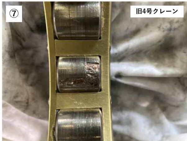
MG駆動用電動機 ベアリング割れ
