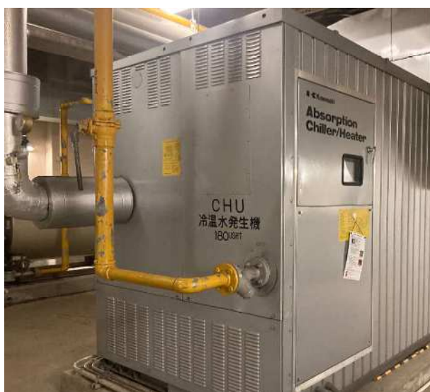
冷温水発生器(空調設備)
