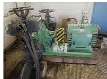
ポンプ設備更新前
