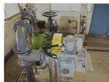
ポンプ設備更新後
