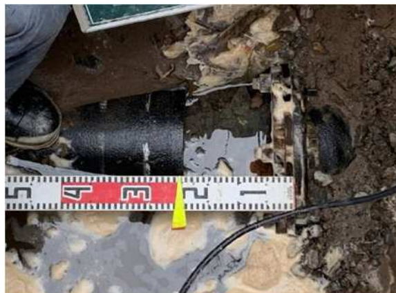
下水道の圧送管の被災
