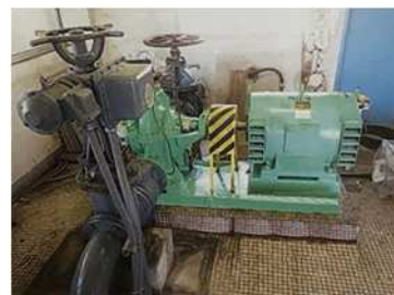
ポンプ設備更新前
