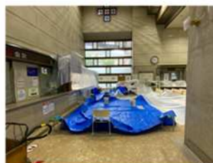
屋上からの雨漏りの状況 (本館1階：令和4年9月)
