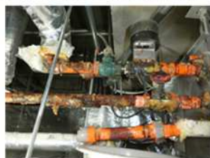
配管の劣化の状況 (管理棟)
