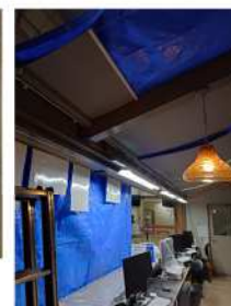
屋上からの雨漏りの状況 (本館1階：令和6年8月)
