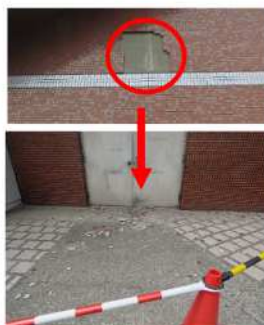
本館外壁タイル落下の状況 (令和3年4月) ※外壁打診調査、補修実施済
