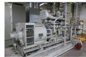
非常用発電装置
