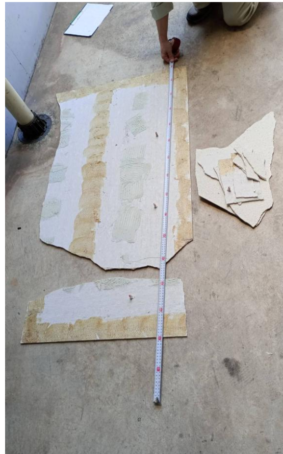
落下した天井仕上げ材
