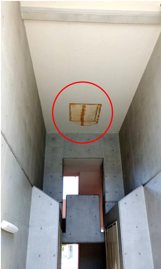
天井落下部分
