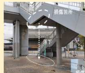
歩道橋化粧板の落下
