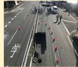
下水道管破損による陥没
