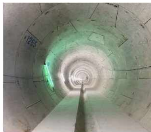
雨水貯留管 (昭和町 貯留管 施工例)
