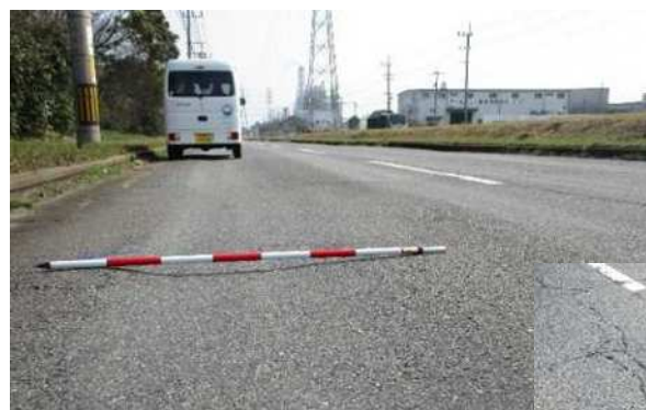
現 状(わだち掘れ)
