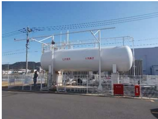
高圧ガス製造施設
