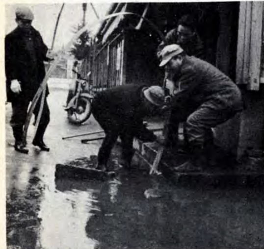
市道の側溝がつまった という、みなさんからの連絡が市民相談室へ毎月5・6件あります。さっそく区土木課員が現地に行き、清掃をしています。 <写真>星陵中前、バス停付近で
