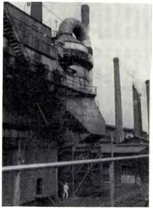
巨大なコットレル集じん装置が、煙突のばいじんを吸いとり、空のよごれを防いでくれる1億円かけた第4製鋼工場の集じん装置
