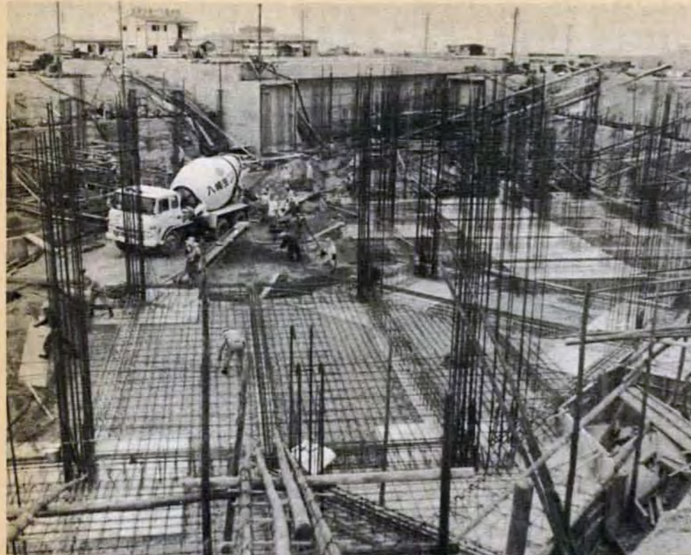
管理塔の建設現場…日明の処理施設を動かす心臓部にあたる管理塔は、電気、機械類を集中操作する建物で、45年5月から動きはじめます。
