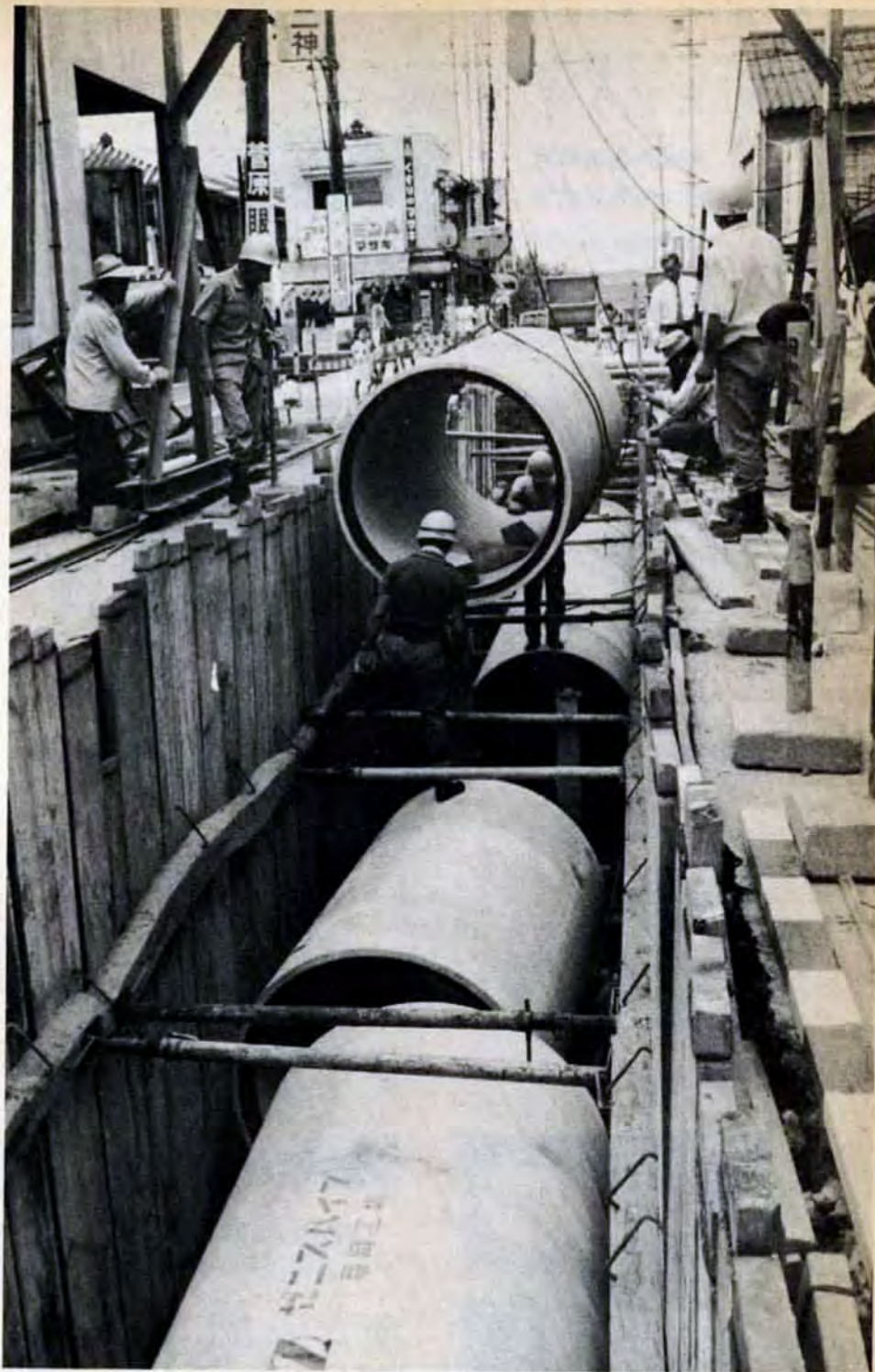
地下に埋められる101億円…総事業費140億円の72%にあたる約101億円が、各家庭から出るし尿や汚水を処理工場まで運ぶ管きょ(延長37万メートル)に費やされます。市街地全域にいきわたらすには、実に560億円(1人当たり5万円)が必要です。<写真は戸畑区工大電停前>
