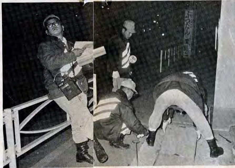
側溝の中で漏水発見。地図に記す。漏水はない方がよいのだが、見つからないと気がなる。
