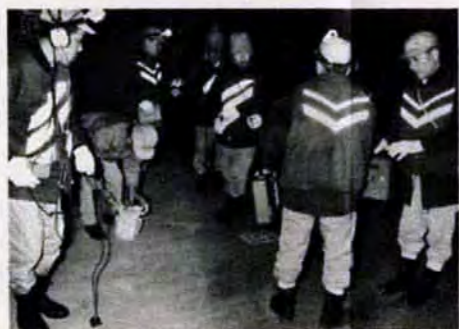
車がとだえた深夜や早朝に水漏れを探す
