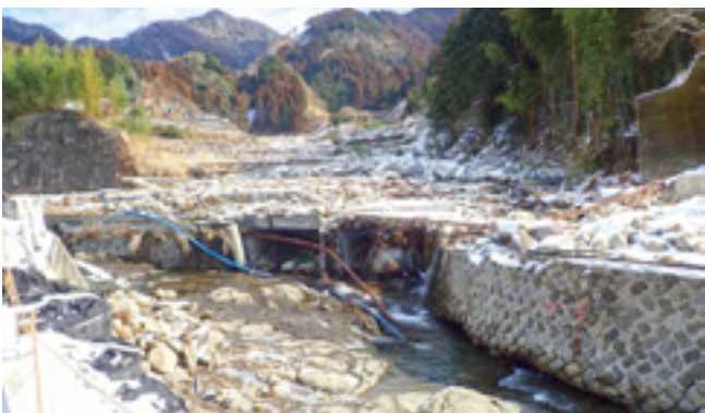
▲筑前岩屋駅付近の被災状況
