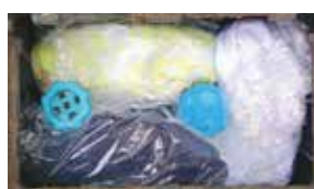
▲水道メーターの保温
