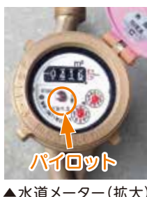
▲水道メーター(拡大)
