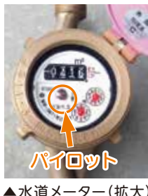
▲水道メーター(拡大)
