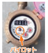
▲水道メーター(拡大)
