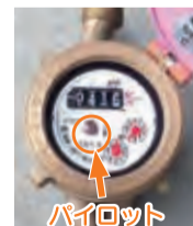
▲水道メーター(拡大)
