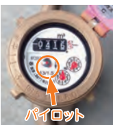
▲水道メーター
