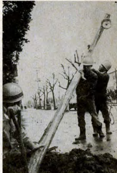
防犯灯1,000灯を設置
