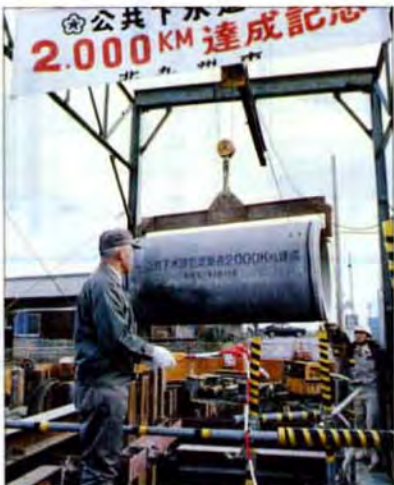
57年1月、下水道管渠が2,000kmに
